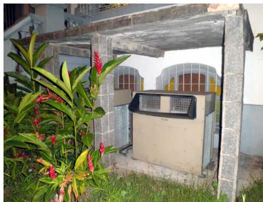
OS COMPRESSORES DOS APARELHOS DE AR CONDICIONADO DOS SALÕES DO SUBSOLO (Foto P. Tosatto)
